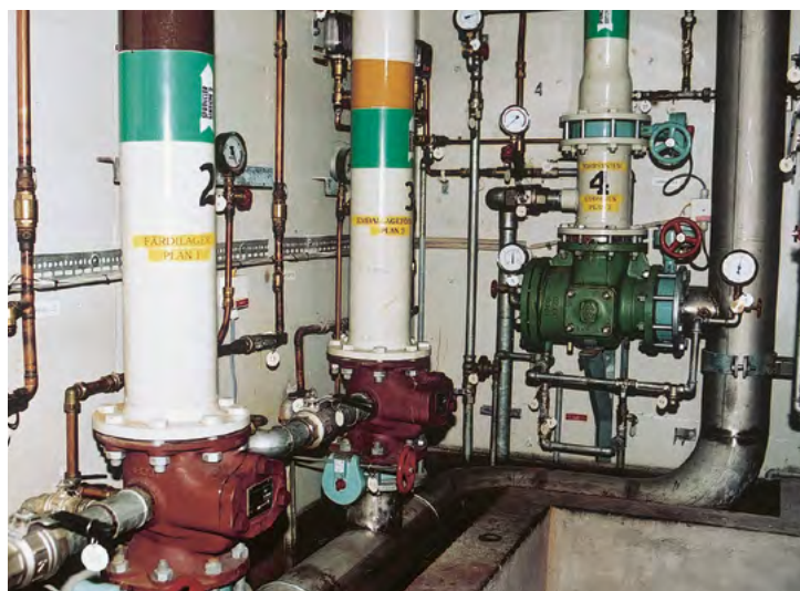
2.98 Vid larm är det räddningstjänstens uppgift att hantera sprinklersystemet. Då gäller det att veta hur systemet fungerar.
