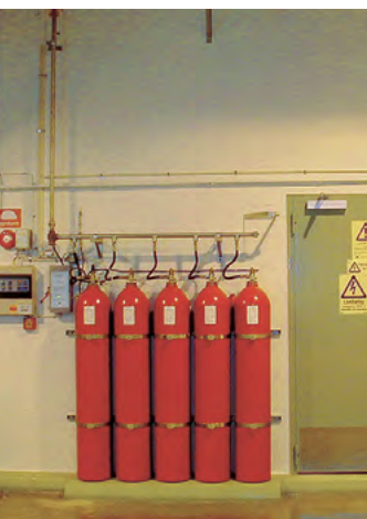
5.6 Fast anläggning med koldioxid som skyddar ett utrymme med mycket viktig elektronik.
