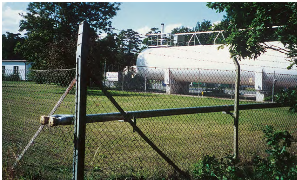
2.99 Vattensprinkler som ska hålla en gastank kyld vid händelse av brand. Kysprinklern förses med vatten av räddningstjänsten. Vattenförbrukningen måste räddningstjänsten ta reda på i förväg.
