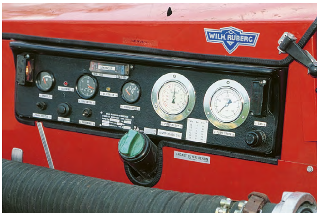
2.18 Manöverpanel för motorspruta med bland annat manovakuummeter och manometer. Observera skylten med omräkningsfaktorer för olika tryckenheter.
